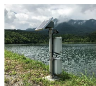
ため池監視装置
