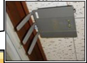
⑥ 無線LANアクセスポイント (2F窓側上部)
