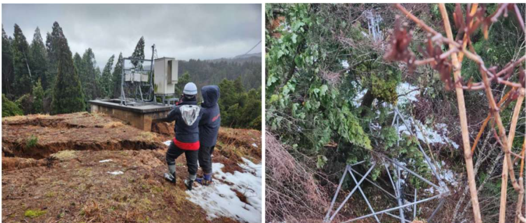
倒壊した基地局
